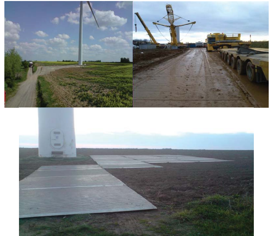
Exemple de plaques qui seront mise en place pour protéger les sols sur le « Crassier »
