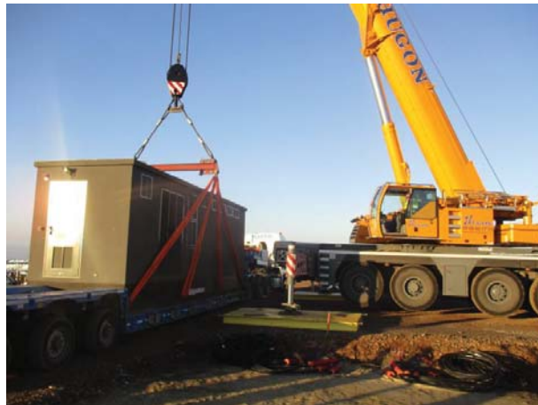
Exemple d'installation d'un poste électrique (photo RES)
