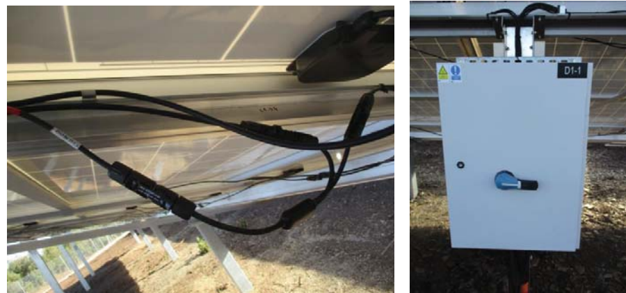
Exemple de câble électrique et de boîte de raccordement (photo RES)
