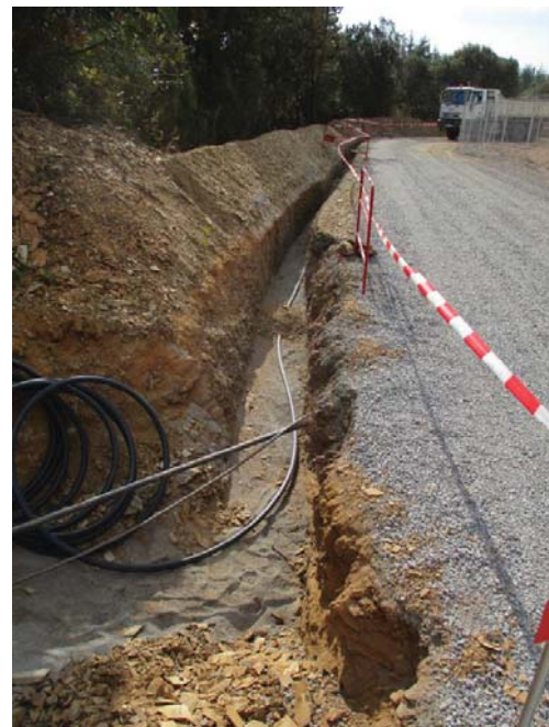
Exemple chemin de câble en bordure de piste (photo RES)
